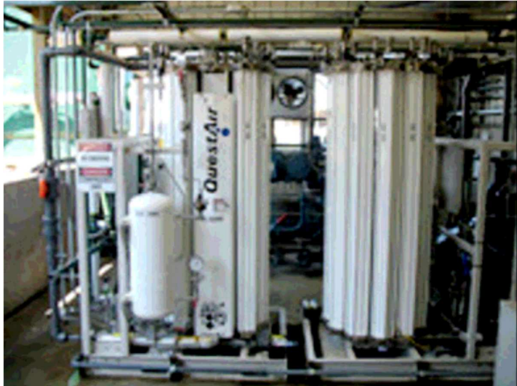
Impianto pilota di purificazione PSA in Svizzera
